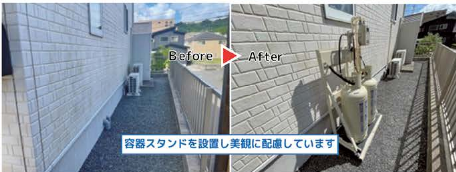
乾太くん専用台を設け洗濯機上部へ設置
