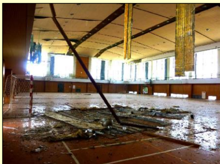
(天井・照明設備の脱落)
