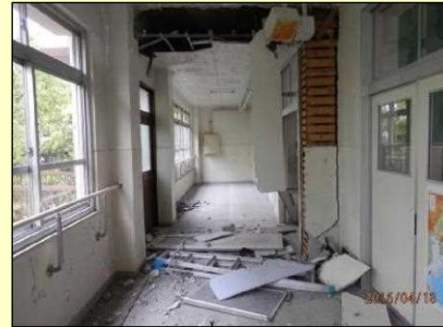
(廊下天井等の破損)
