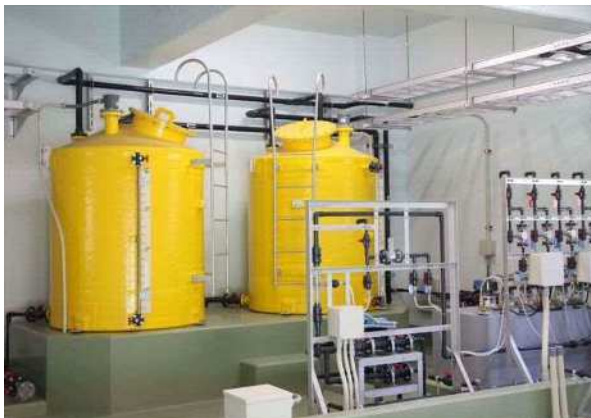
浄水処理設備（塩素消毒）
